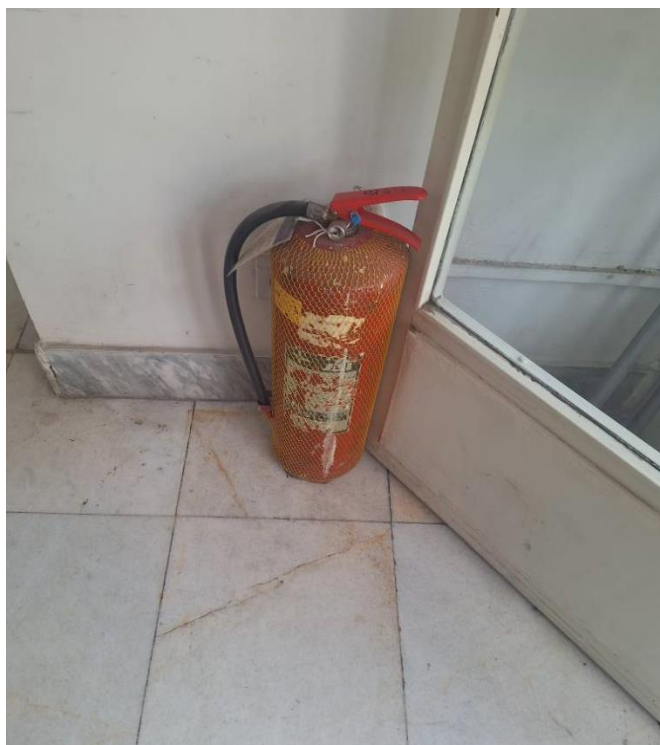
عدم نصب کپسول اطفاء حریق
